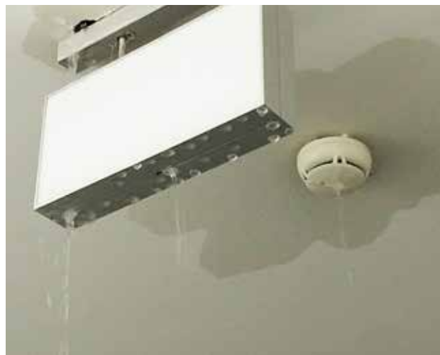
Durch Rauchmelder und Fluchtwegschild floss das Wasser aus dem Rohrbuch im Zwischengeschöß wasserfallartig herunter
